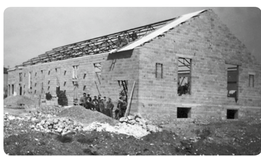
En 1954, les quatre murs sont debout, la charpente est installée, tous mettront les bouchées doubles pour finir la toiture avant l'été et la cérémonie des communions solennelles.
